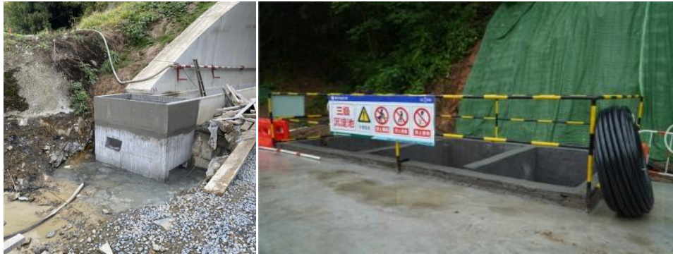
图 16 公路隧道洞口设三级沉淀池
